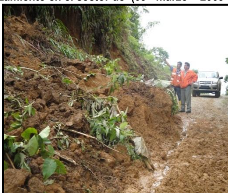
Fotografía 2. 6 Deslizamiento en el sector de (09- marzo – 2009 Sector Santa Mónica)
