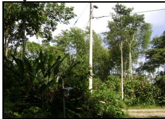
Fotografía 2. 27 Sistema de Iluminarias Públicas
